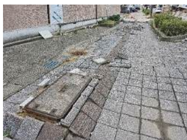
▲隆起した歩道
