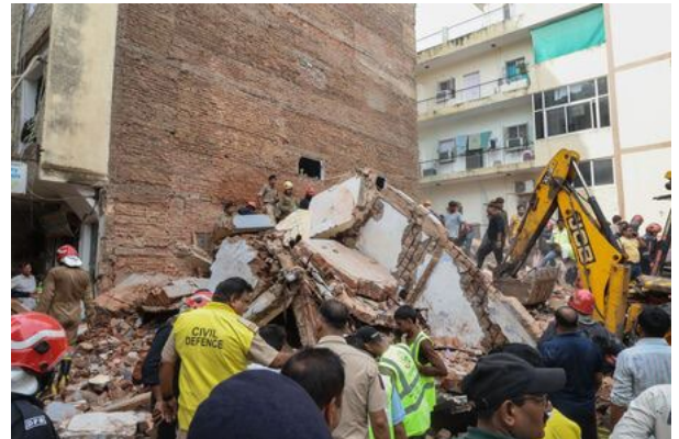
崩落現場での救助作業＝6日、ニューデリー（EPA時事）
